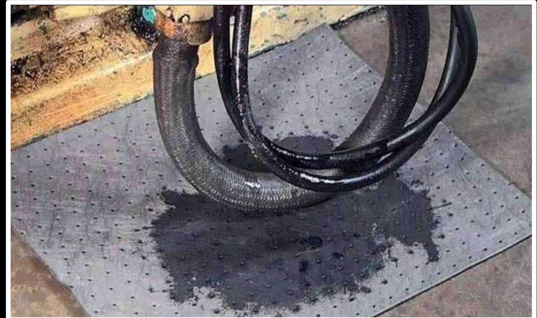
Fuga de fábrica en el sistema hidráulico
